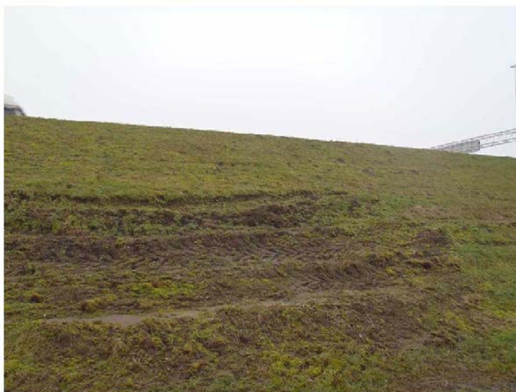
Foto: Maaischade aan afdeklaag.
