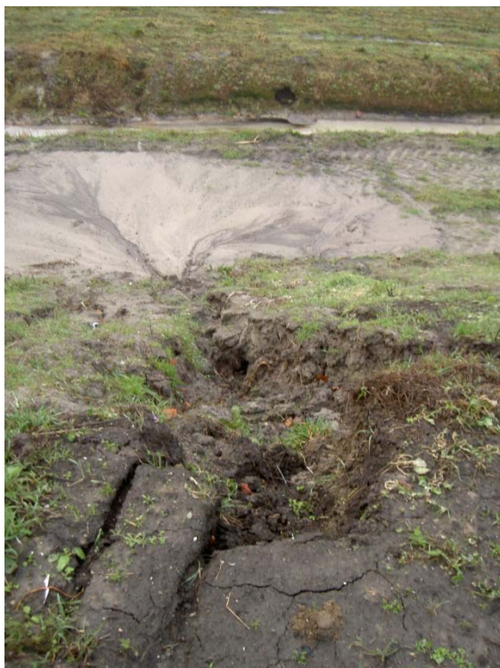
Foto: Erosie van afdeklaag.
