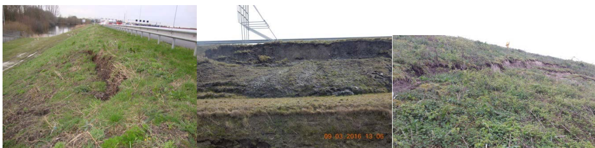
Foto: Afschuiving van talud.
